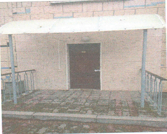
Фото №27 — входная дверь центрального входа (правая сторона)
