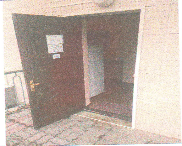
Фото №28 — входная дверь центрального входа (правая сторона)
