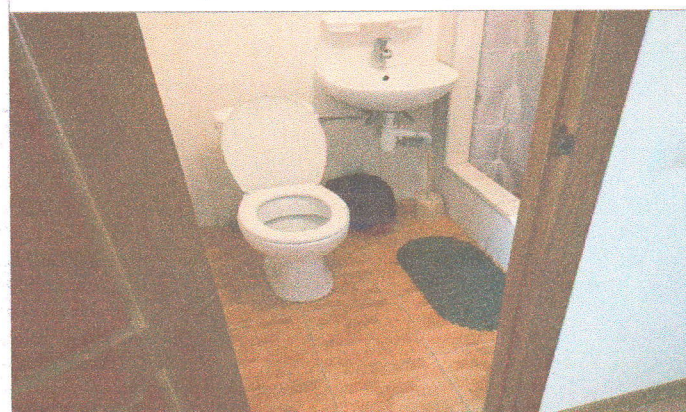
Фото № 61— Санитарно-гигиеническое помещение в номере
